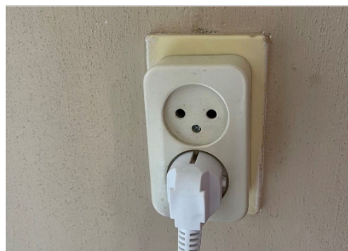
Foto 106: Dubbele opbouw wandcontactdoos niet voorzien van randaarde.
