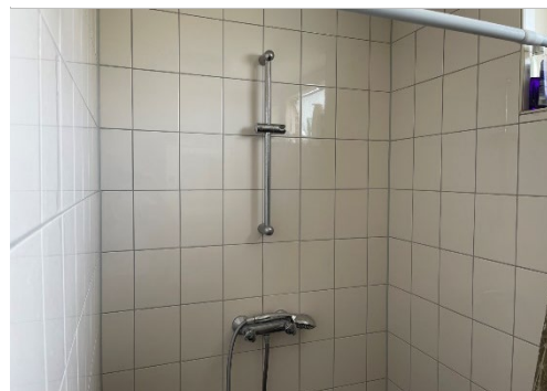
Foto 82: Het wandtegelwerk in de douchehoek loopt door tot aan het plafond.
