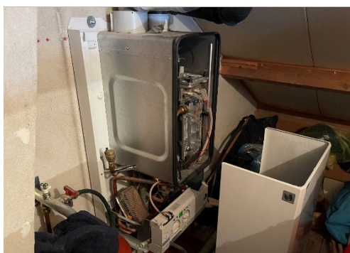
Foto 90: Lange Heul 171; opstelplaats CV-ketel op zolder.
