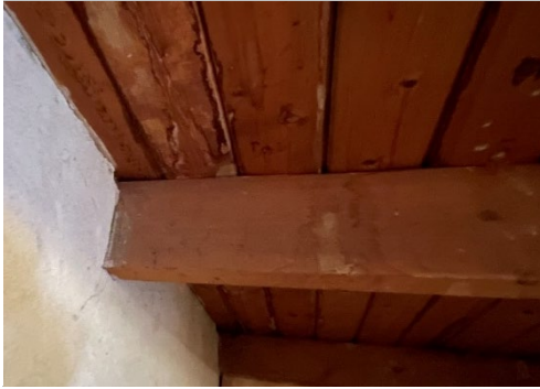
Foto 8: De aanwezige gordingen lopen door tot in de woningscheidende bouwmuur.
