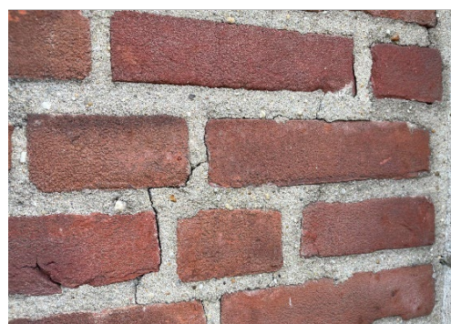
Foto 27: De staat van het voegwerk is matig, er zijn nog weinig uitgespoelde voegen geconstateerd.
