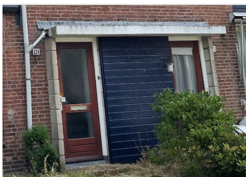
Foto 28: De aanwezige luifel is een aandachtspunt t.a.v. een mogelijke koudebrug.
