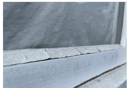
Foto 66: Stopverfzomen zijn gebarsten en onthechten van de ondergrond.
