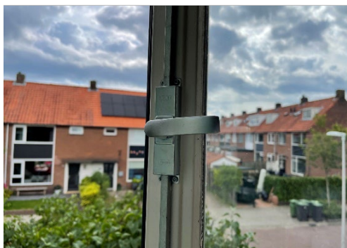
Foto 49: Espagnoletsluiting niet voorzien van een SKG keurmerk.
