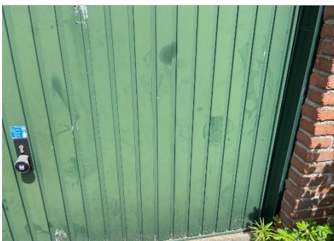
Foto 65: Het buitenschilderwerk verkeert in een slechte staat. De glansgraad is gedegradeerd en het verfysteem poedert af.
