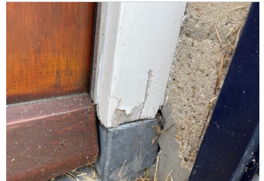
Foto 62: Het buitenschilderwerk verkeert in een slechte staat. Er komt veel verschade voor zoals bladderen en barsten van het verfysteem.
