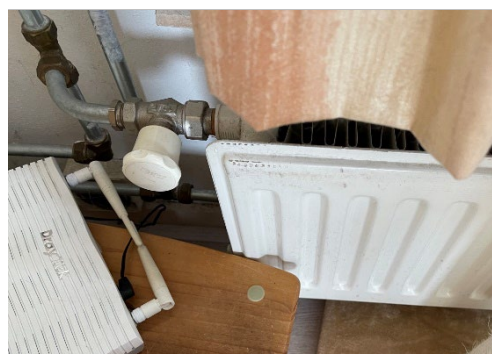
Foto 93: Open/dicht radiatorkranen aanwezig op de radiatoren.
