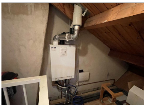
Foto 88: Bijenschans 32; opstelplaats CV-ketel op zolder.
