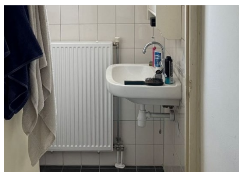
Foto 95: De radiator aanwezig in de badkamer toont recenter dan de overig aanwezige radiatoren in de woning.
