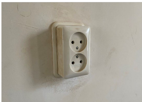
Foto 105: Dubbele opbouw wandcontactdoos niet voorzien van randaarde.
