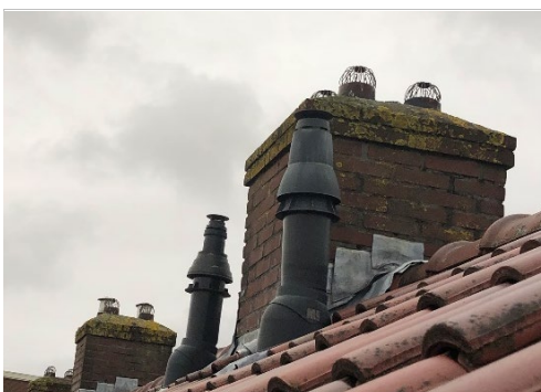
Foto 12: Visueel zijn er niet direct grove gebreken aan de schoorstenen waarneembaar.
