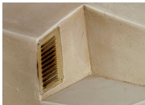
Foto 97: Rooster aanwezig op het natuurlijke ventilatiekanaal aanwezig in de keuken.
