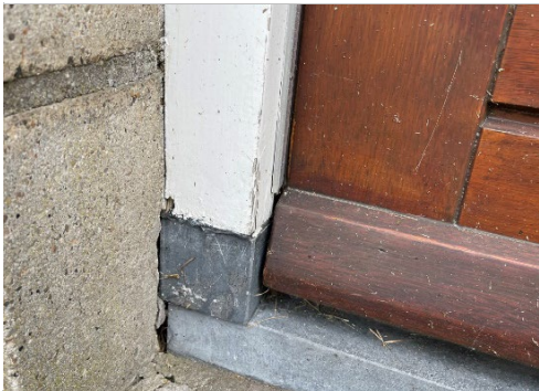
Foto 61: Het buitenschilderwerk verkeert in een slechte staat. Er komt veel verschade voor zoals bladderen en barsten van het verfysteem.
