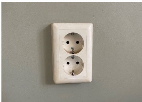
Foto 107: Dubbele opbouw wandcontactdoos voorzien van randaarde.
