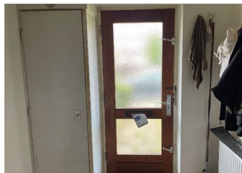
Foto 46: De woningentreedeur is niet voorzien van een driepuntssluiting. Aanvullend zijn zodoende een tweetal raamboompjes geplaatst.
