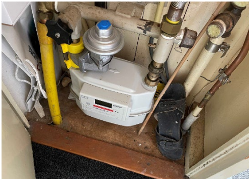
Foto 102: In de meterkast zijn de individuele gasmeters aanwezig. De inkomende gasleiding is voorzien van een gele mantelbuis.
