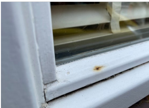
Foto 63: Een corroderende nagel.
