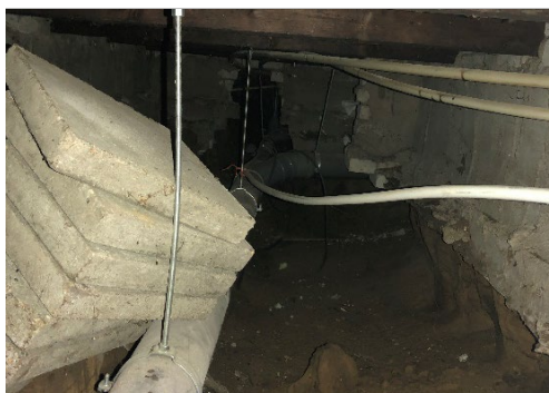
Foto 76: Een stapel betontegels ligt tegen / op de pvc rioleringsbuis.
