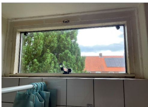
Foto 96: Te openen uitzetraam voor ventilatie in de badkamer.
