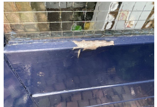
Foto 64: Het buitenschilderwerk verkeert in een slechte staat. Er komt veel verschade voor zoals bladderen en barsten van het verfysteem.
