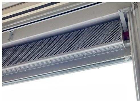
Foto 99: Aanwezig ventilatierooster op het glas voor aanvoer van buitenlucht.
