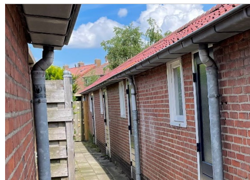
Foto 21: Over het algemeen zijn de dakgoten van de bergingen en garages verbonden middels een stuk(je) PVC buis op de stalen afvoer
