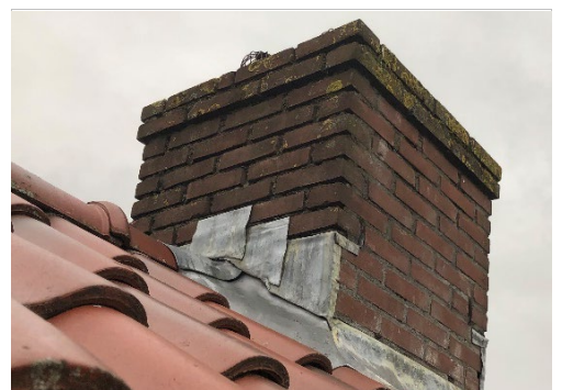
Foto 13: Visueel zijn er niet direct grove gebreken waarneembaar. Wel ontbreekt er behoorlijk voegwerk (m.n. tpv weersgevoelige zijde)
