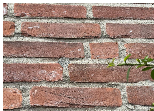
Foto 25: De staat van het voegwerk is matig, de gevelvlakken zijn behoorlijk verzand.
