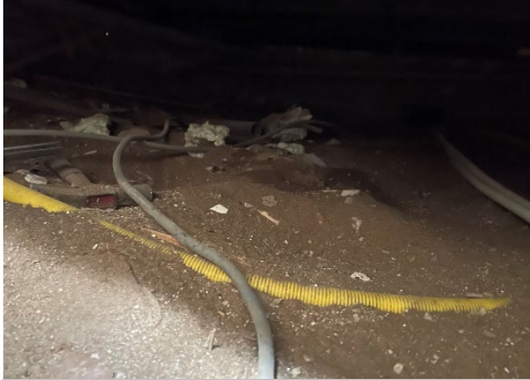
Foto 100: De inkomende gasleiding lijkt reeds vervangen en is daarbij voorzien van een gele mantelbuis.
