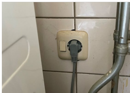
Foto 108: Enkele opbouw wandcontactdoos met schakelaar voorzien van randaarde.
