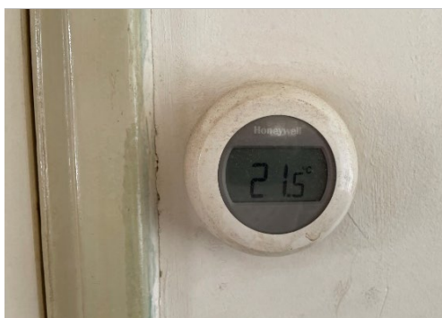
Foto 92: Regeling middels een kamerthermostaat.
