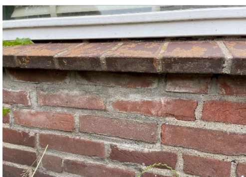
Foto 26: De staat van het voegwerk is matig, er hebben reparaties plaatsgevonden.
